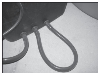
Salidas que no se utilizan conectadas por tubos
